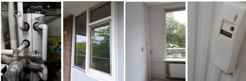
Figuur 4 – vlnr het collectieve boilervat, sandwichpanelen, stijgleidingen en verdampingsmeter
