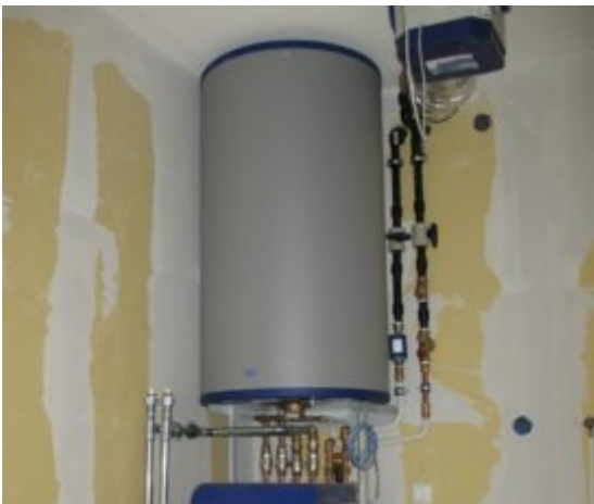
Figuur 7 – Boilervat van boosterwarmtepomp voor warmtapwater
