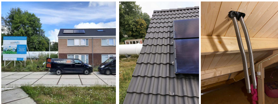
Figuur 7 a,b,c: a) pilotwoning b) PVT panelen op het dak c) aansluitleidingen van de PVT. Deze zullen worden aangesloten aan de afleverset in de woning.
