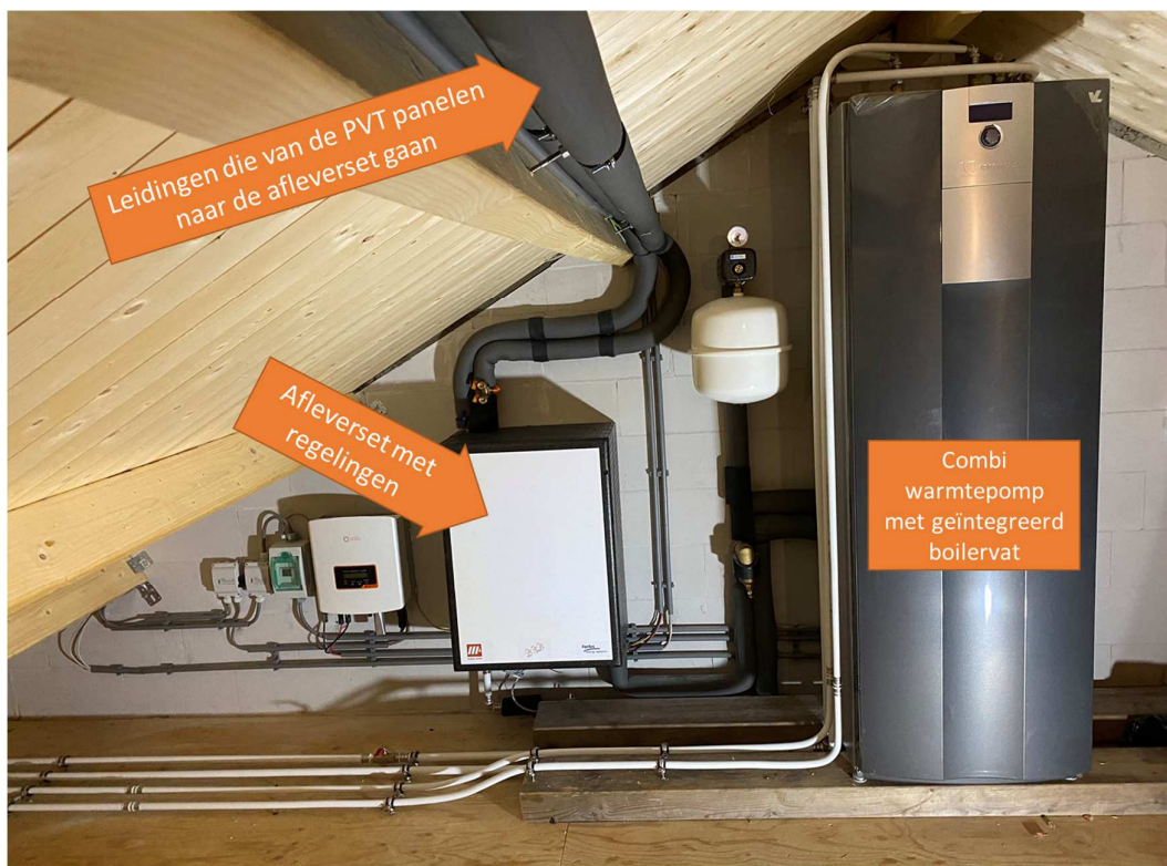
Figuur 8: warmtepomp, afleverset en aansluiting PVT panelen bij de proefopstelling bij The Green Village ( https://www.youtube.com/watch?v=q36WRPq85jq )
