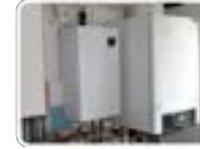
Installatie in huis
