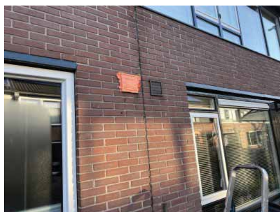
Kanaal afzuigkap afgeplakt
