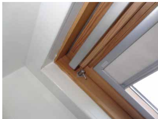
Ventilatie-rooster dakramen gesloten
