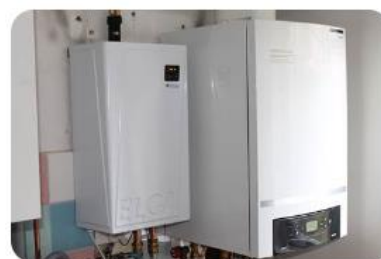
Binnen: links de warmtepomp, rechts cv-ketel
