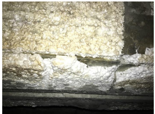
Bestaande isolatie laat los. Foto: Rob van Houten
